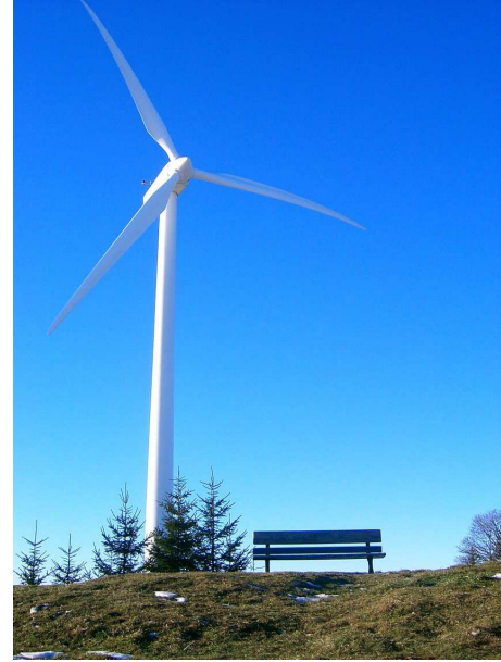
FIGURE 7.6 – Éolienne L'énergie paisible
