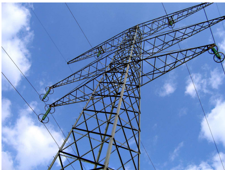
FIGURE D.1 – Ligne de haute tension Pylône et isolateurs d'une ligne de 400 kV 29
